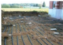
Erd-Wärmepumpe mit Erdkollector
