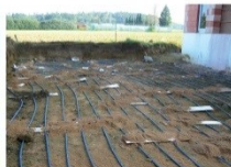
Erd-Wärmepumpe mit Erdkollector
