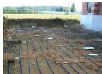
Erd-Wärmepumpe mit Erdkollector
