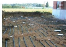
Erd-Wärmepumpe mit Erdkollector
